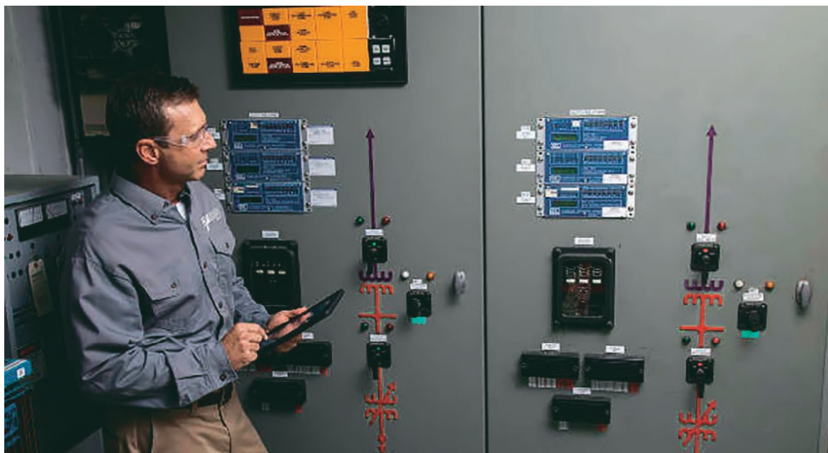
Fot.2. Opracowano plan testów funkcjonalnych, a następnie zgodnie z nim przetestowano kompletny system w celu zapewnienie prawidłowego funkcjonowania. Źródło: High Voltage Maintenance
