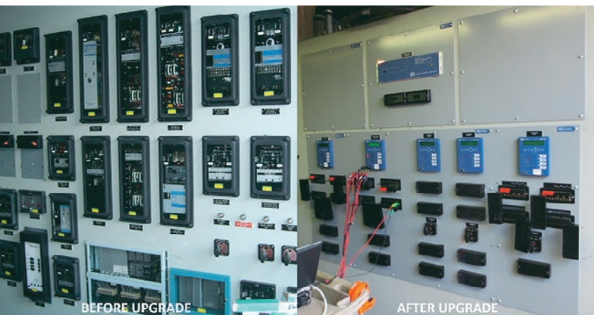
Fot. 1. Rozdzielnica przed i po modernizacji zabezpieczeń przekaźnikowych.
