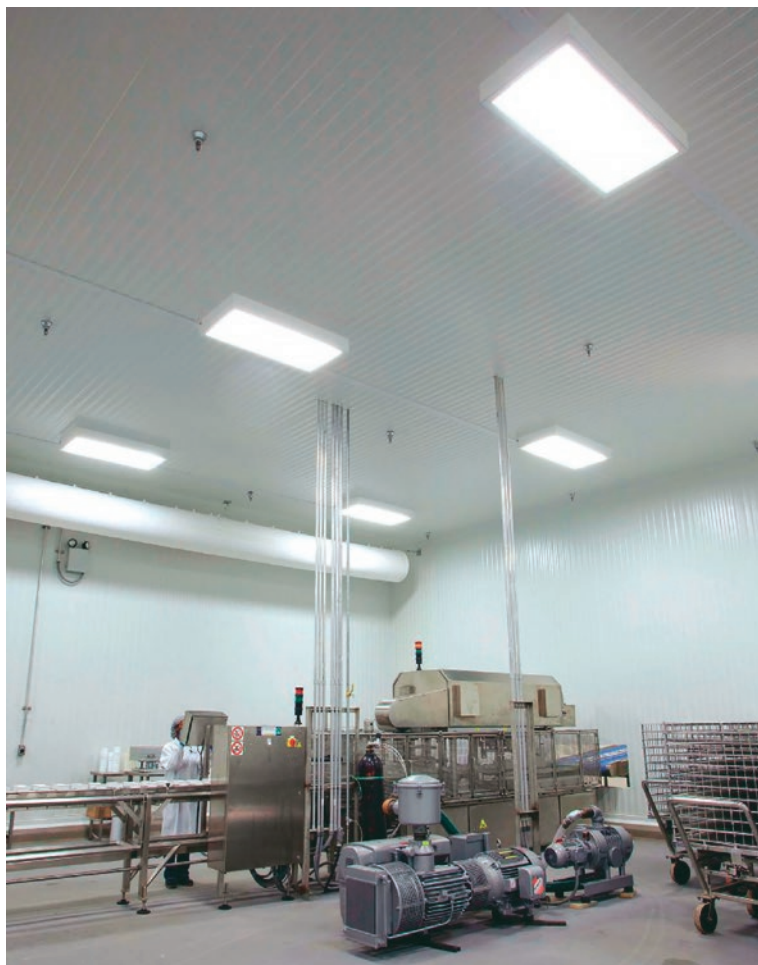
Fot. 1. Hermetyczne oprawy oświetleniowe, zainstalowane w fabryce firmy U.S. Pet Nutrition w Lyons (stan Georgia), posiadające certyfikaty głównych organizacji akredytacyjnych, w tym FDA oraz Kanadyjskiej Agencji Inspekcji Żywności (Canadian Food Inspection Agency). Źródło: Kenall Manufacturing Co.
