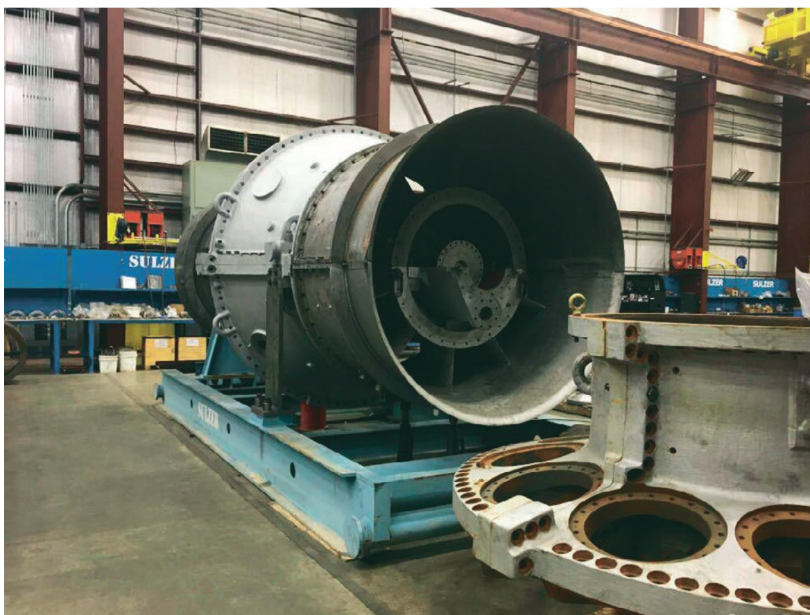
Duże przemysłowe turbiny gazowe wymagają przestronnych i dobrze wyposażonych centrów serwisowych. Dzięki uprzejmości: Sulzer
