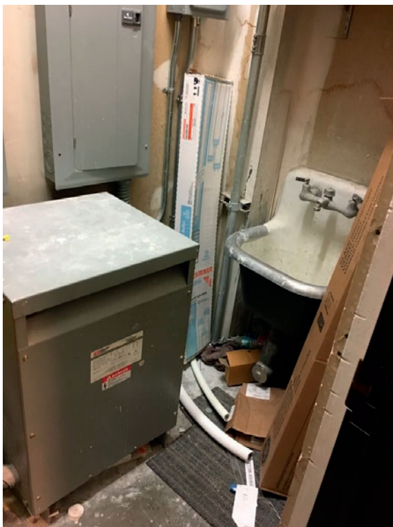
Rysunek 4: Przykład nieprawidłowej instalacji transformatora. Widoczny bałagan instalacyjny, materiały łatwopalne i woda w pobliżu. Dzięki uprzejmości: ABB
