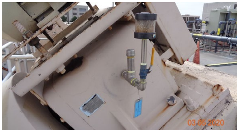
Foto 2: Filtr pochłaniający wilgoć zainstalowany na odpowietrzniku napędu przekładni w Upper Occoquan Service Authority.
