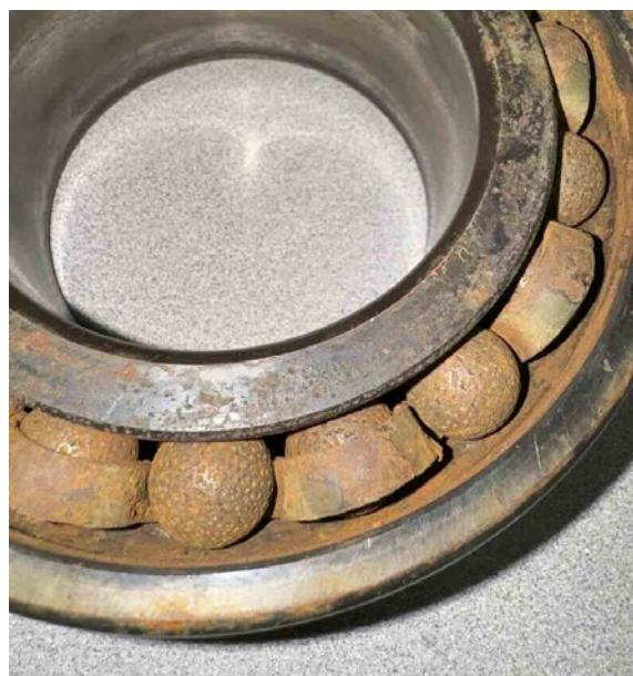
Foto 1: Łożysko napędu przekładni głównej osadnika wtórnego.
